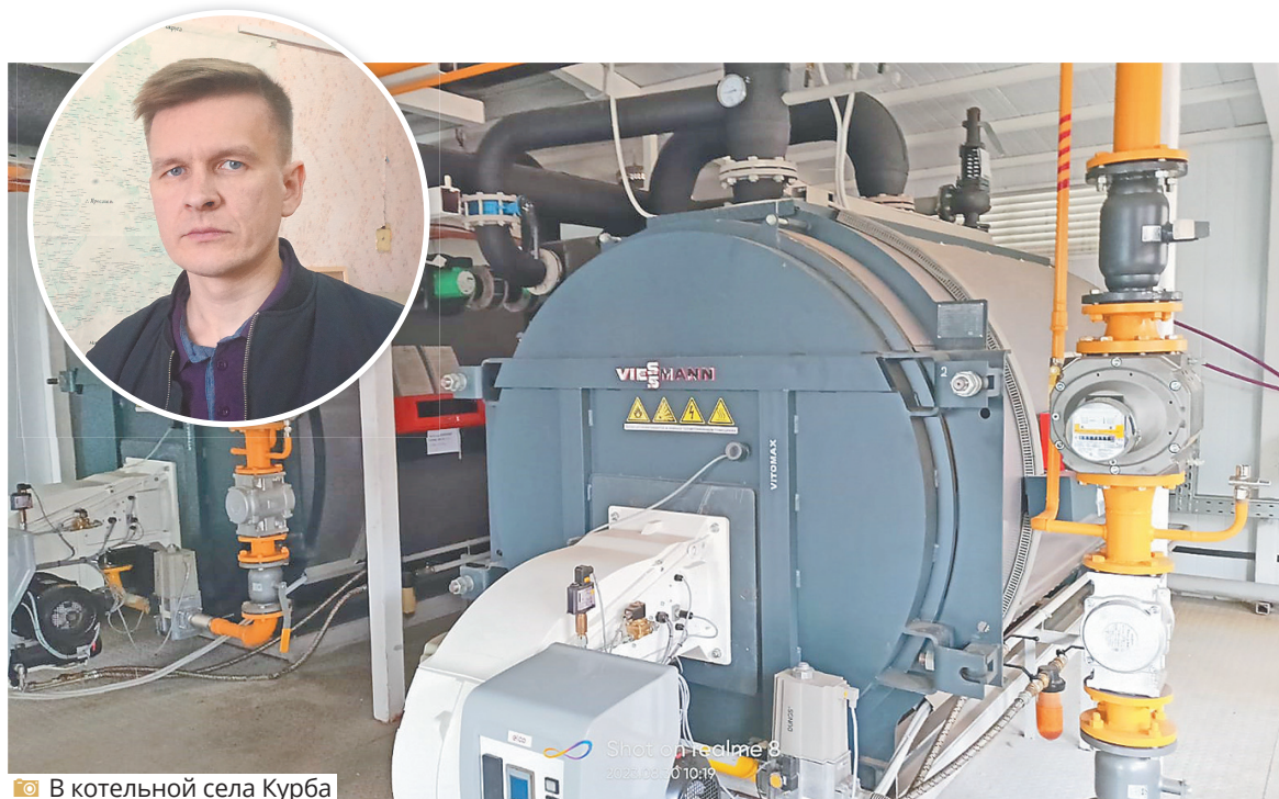
В котельной села Курба
